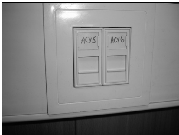
Рис. 1.6. Гнезда розеток, закрытые заслонками
