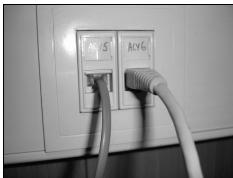
Рис. 1.5. Телефонный и компьютерный кабели подключены в одинаковые гнезда
